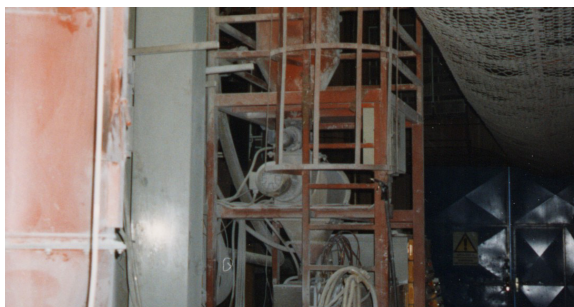
Abb. 6.1.1 Restpulver oder Schmutz in der Beschichtungskabine
