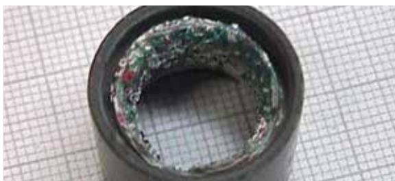
Fig. 2.2.5 Matériau des tuyaux inadéquat
