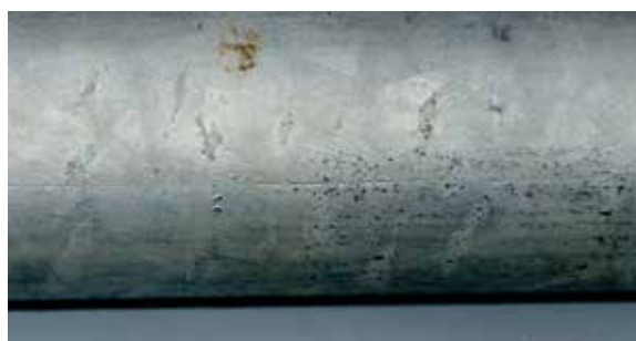
Fig. 3.5.8. Galvanisation par bain chaud insuffisante
