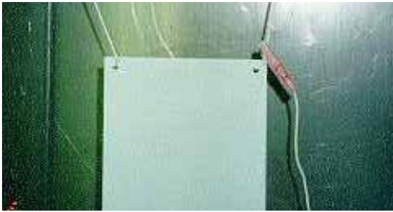
Fig. 2.3.3 No hay Conexión a tierra o es ineficaz
