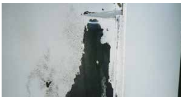
Fig. 2.3.1 Partes de capa de polvo se desprenden
