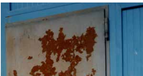
Fig. 5.2.3 Escoria, oxidación superficial, óxido blanco
