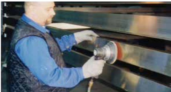
Fig. 3.5.1 Contaminación de la superficie de la pintura derivada de los trabajos de desbastado
