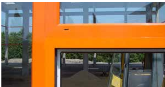
Fig. 4.1.1 Color distinto debido a los distintos grosores de capa
