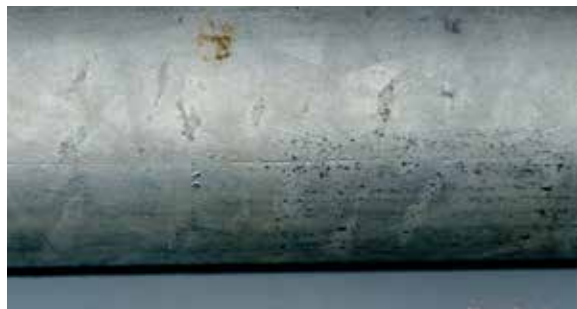
Fig. 3.5.8 Galvanizado por inmersión en caliente defectuoso
