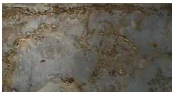
Obr. 1.3.4 Nedostatečné opláchnutí, následně uloženo vlhké
