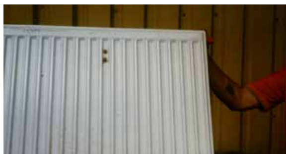
Obr. 5.2.2 Nevhodná nebo nedostatečná předúprava
