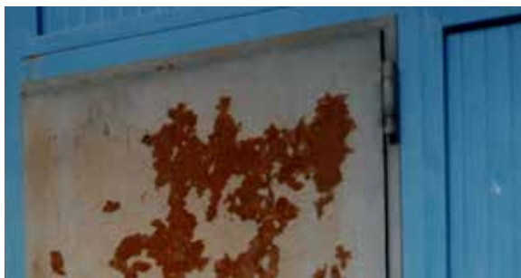
Obr. 5.2.3 Šupiny, vzdušná koroze, bílá koroze
